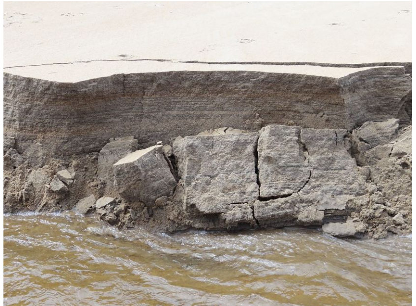
Erosion à l'extérieur du virage
